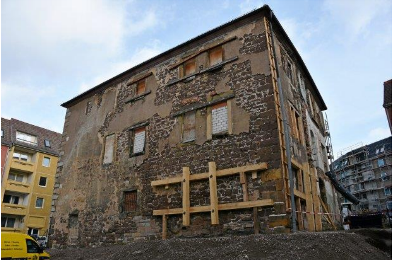
Die Stadt Gotha lässt derzeit das alte Amtshaus in der Augustinerstraße statisch sichern. Foto: Claudia Klinger
